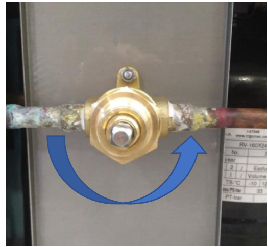
Image 7 : Tournez-le dans le sens inverse des aiguilles d'une montre pour ouvrir les deux robinets
